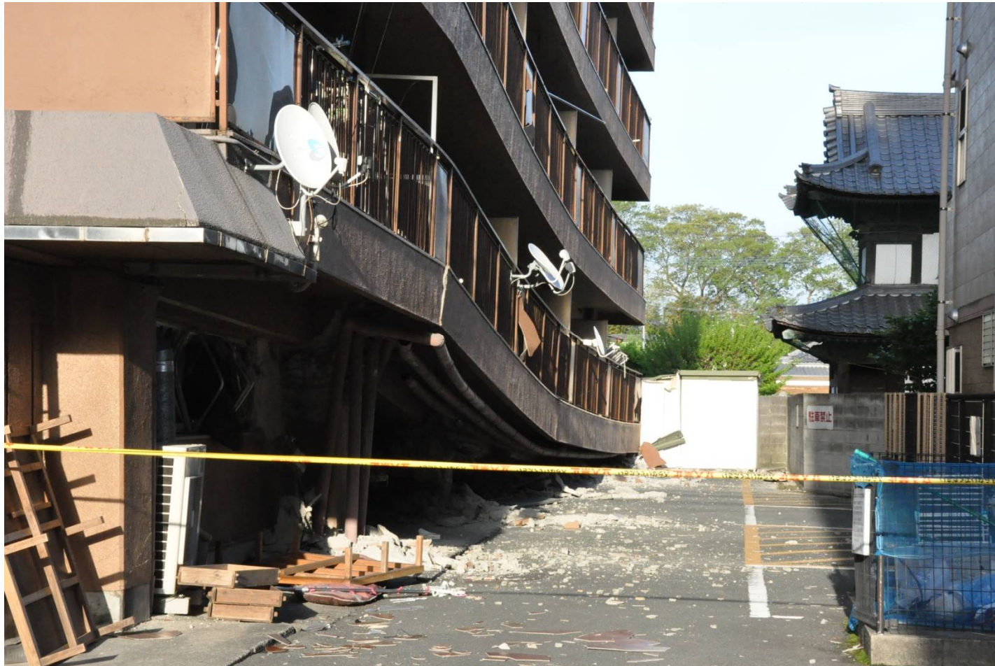
ピロティ形式の7階建てRC造マンション 1階部分の柱が座屈(熊本市西区出町1丁目) 直ぐ横の寺の楼門には目立った被害なし
